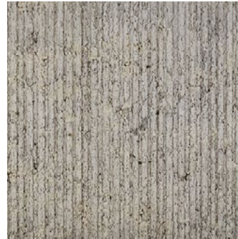
Betonové části terasy - škrábaný beton
