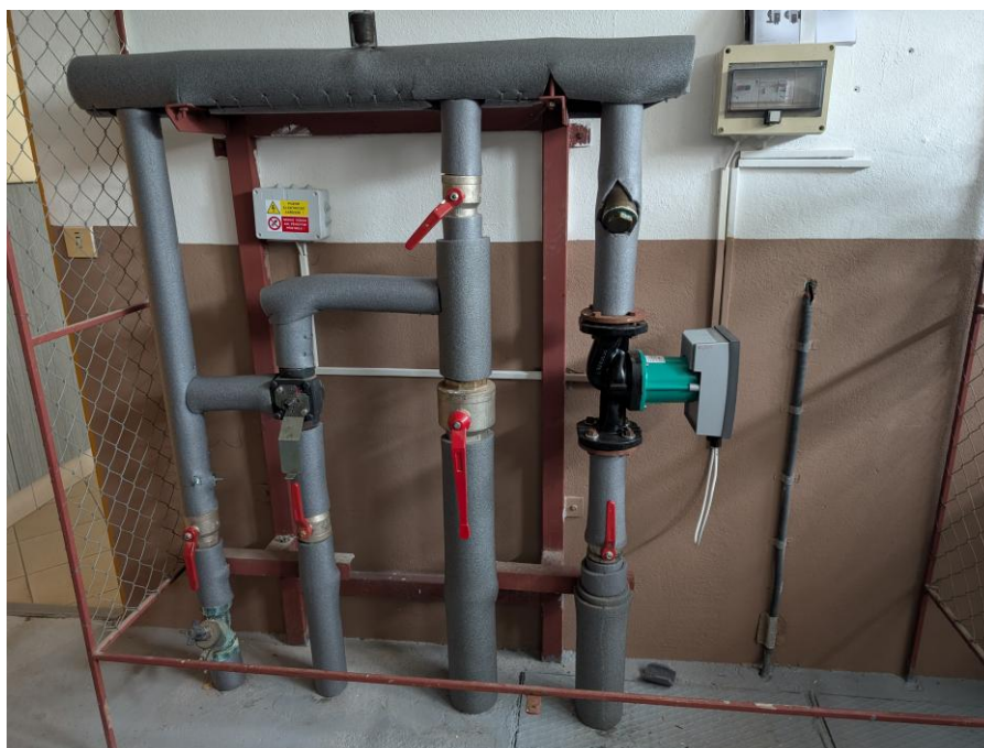
Obrázek 66: pohled na předávací stanici
