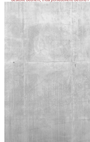
POHLEDOVÉ BETONOVÉ KONSTRUKCE prefabrikované dílce skeletu a monolitické konstrukce nosných prvků deskové bednění, třída pohledového betonu PB3
