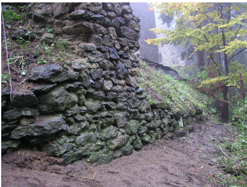
Detailní pohled na část zachovalého líce sevrní zdi hradeby za ren.palácem – patrný odskok – rozšíření zdiva s úrovní těsně u terénu stávajícího, horní část příčné zdi západní bastionu s trhlinou – resp. odtrženou dozdívkou z 20.století
