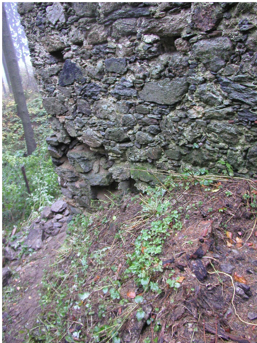
Detail poškození, resp.odpadlé dodatečné plomby na západní stěně bastionu v místě kde má probíhat těleso severní hradby renes.paláce
