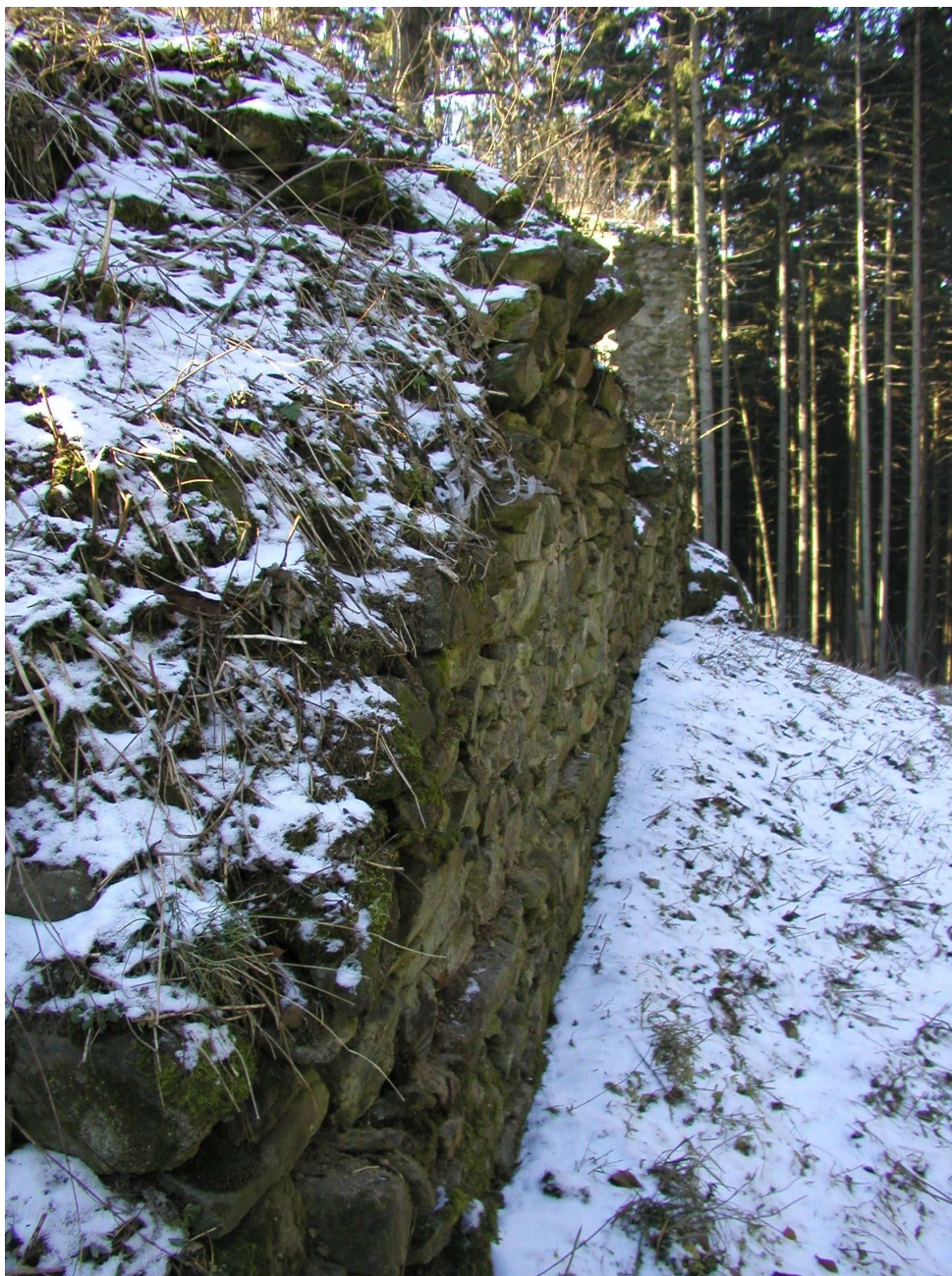
Stav koruny severní zdi bastionu – stav: drn, rozvolněné 3-4 šáry, následně značně rozvolněné zdivo s nutností hloubkového spárování a klínování, výrazná stavební přestávka – dělicí fáze výstavby (úrovně lešení), spodní část částečně rozrušené spárování s nutným doklínováním a spárováním (pohled od východu – stav prosinec 2007).
