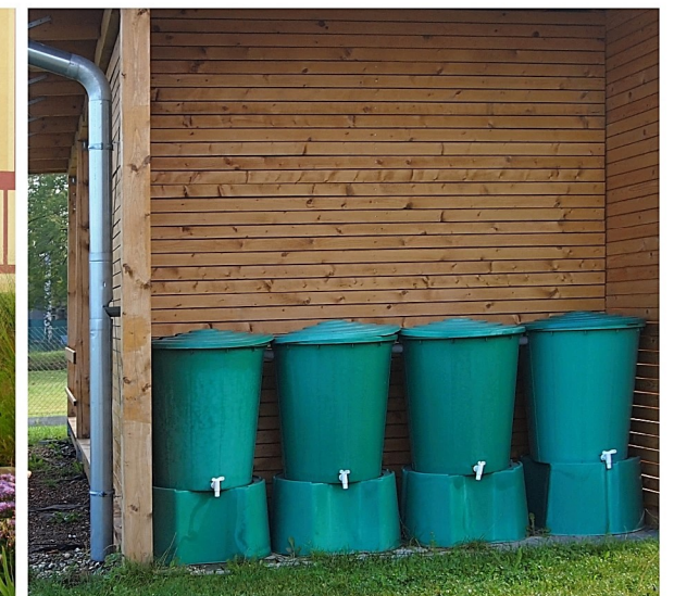
propojené nadzemní akumulční nádrže na dešťovou vodu ze střechy využívané na dešťovku (s kohoutkem)
